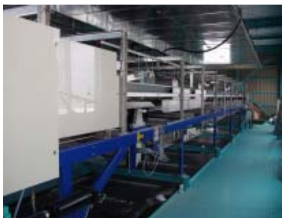
写真 4.2 脱水・洗浄装置
